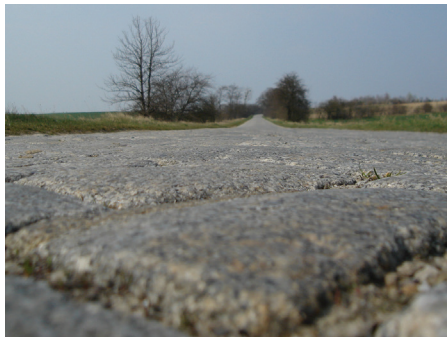
Figura 4.7: Foto de uma estrada em péssimo estado de preservação
